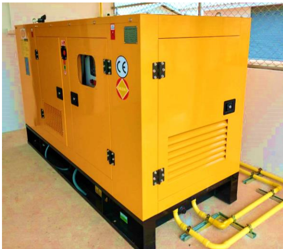
เครื่องกำเนิดไฟฟ้า ขนาด ๑๕ กิโลวัตต์
