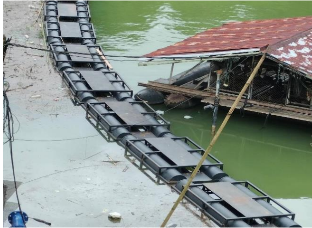
แพสูบน้ำพร้อมติดตั้งเครื่องสูบน้ำด้วยไฟฟ้าในบริเวณท้ายน้ำของห้วยซอกกาเรีย
