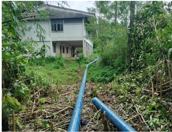
อยู่ระหว่างดำเนินการวางระบบท่อส่งน้ำขนาดเส้นผ่านศูนย์กลาง ๒๐๐ มิลลิเมตร จากแพสูบน้ำไปยังถังพักน้ำ ระยะทางประมาณ ๑,๙๐๐ เมตร
