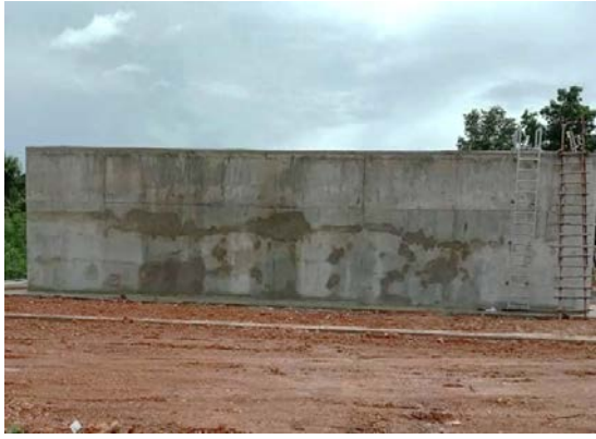
ถังเก็บน้ำความจุ ๗๘๐ ลูกบาศก์เมตร
