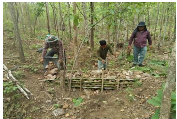
สร้างฝายชะลอน้ำ เพื่อความชุ่มชื้นบริเวณป่าต้นน้ำ
