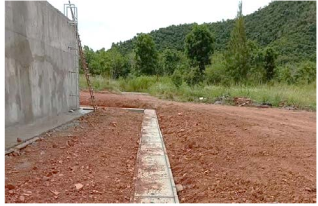
ระบบท่อส่งน้ำจากโรงสูบน้ำไปยังถังพักน้ำ
