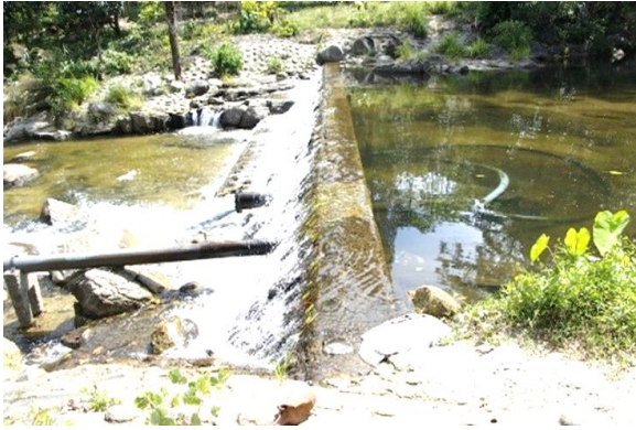
สภาพของฝายทอน้ำเดิม
