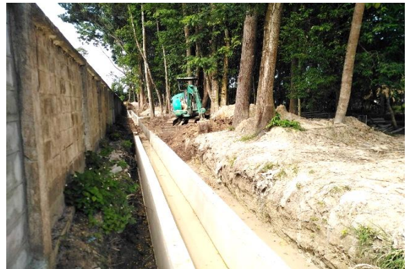
การก่อสร้างคูระบายน้ำโดยรอบพื้นที่โรงเรียน
