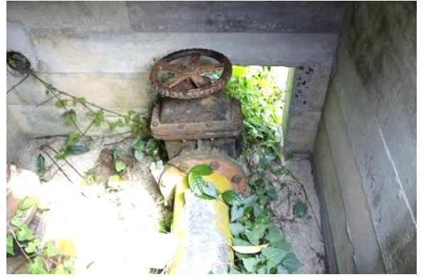
ระบบท่อส่งน้ำเดิม
