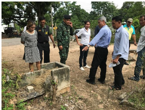
เจ้าหน้าที่และชาวบ้านร่วมกันตรวจสอบรางส่งน้ำระบบเปิด ที่ชำรุดเสียหายใช้การไม่ได้
