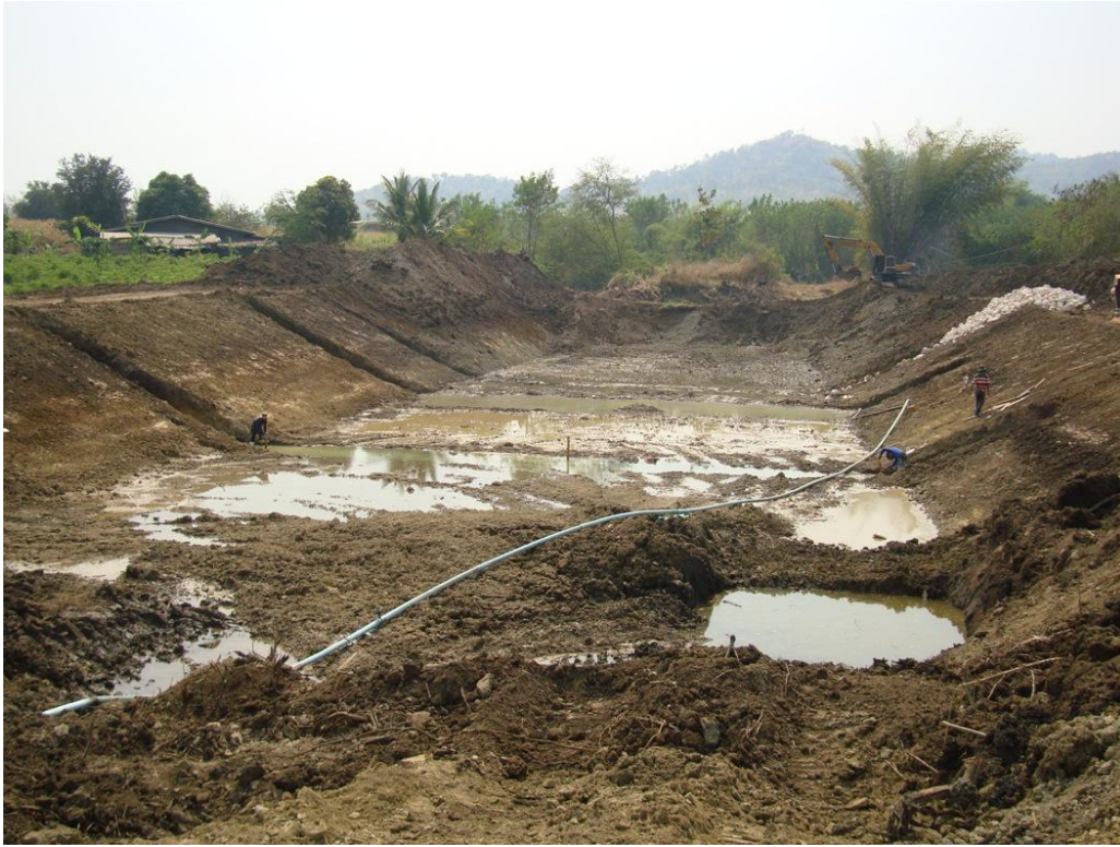
งานก่อสร้างฝายหินก่อ ๑ แห่ง บริเวณลำห้วยพู่ช้างหมอบ ความยาว ๒๙ เมตร ความสูง ๒.๒๕ เมตร ขณะนี้ดำเนินการได้ร้อยละ ๓๐
