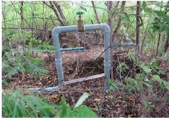
ระบบส่งน้ำเข้าแปลง
