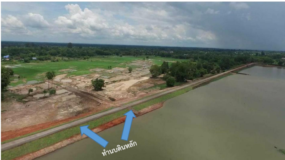
บริเวณที่ทำการซ่อมแซมทำนบดินหลัก แล้วเสร็จเมื่อวันที่ 22 สิงหาคม 2560
